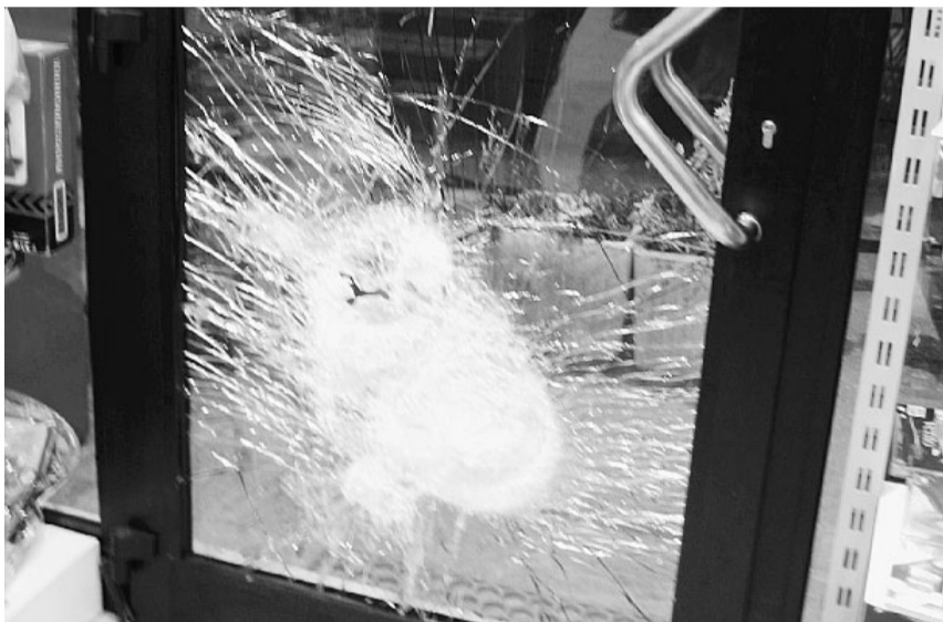
La porta danneggiata
